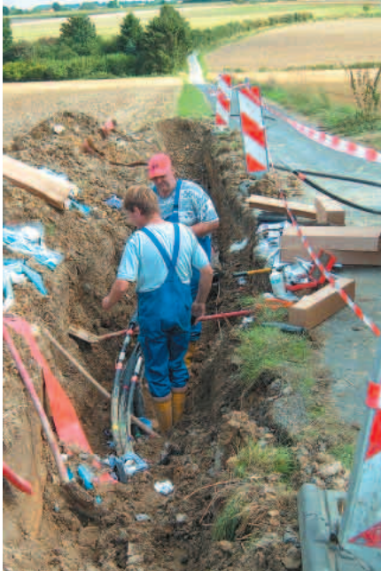
Tauschaktion mit Schaufel: 26 Löcher mussten gegraben werden, um insgesamt 108 Muffen zu ersetzen.
