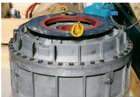
Windkraft Oesbern: Eine undichte „Fludex“-Kupplung wurde im Rahmen der Garantie gegen ein neues Teil getauscht.
