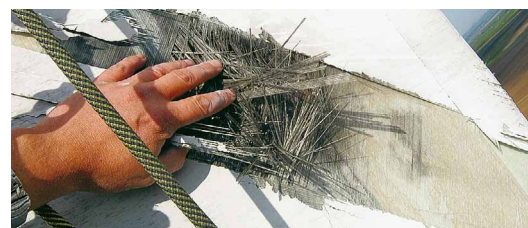
Die Glasfaserlagen wurden vom Einschlag aufgesprengt
